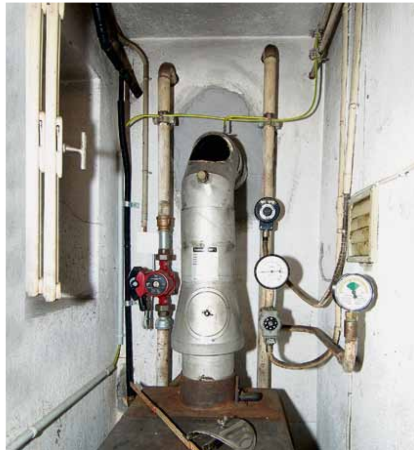
Das sind die Platzverhältnisse im Heizraum, ein Umbau ist nicht gut möglich: Seitlich je 10 cm, vorne beim Brenner ca. 50 cm. Der sehr warme Heizraum ist für die Hausbesitzerin perfekt geeignet, in der hohen Umgebungstemperatur ihre Pilze zu trocknen.
