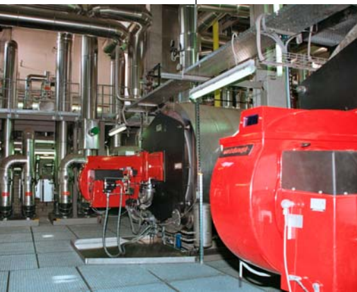
Gas-Öl-Zweistoffbrenner Weishaupt RGLN 70, 6 MW, bei Cilag, Schaffhausen (Foto: Weishaupt AG)
