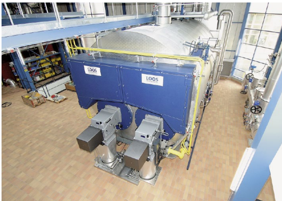
Für die Abdeckung der Spitzenlast werden moderne Gaskesselanlagen eingesetzt. Beim abgebildeten Dampfkessel handelt es sich um einen Dreizug-Doppelflammrohrkessel, Fabrikat Loos. (Bild: Hans-Peter Läng)
