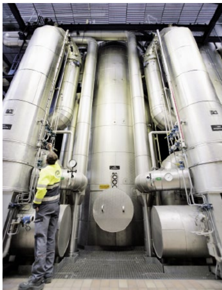
Mitarbeitender vor Umformer. (Bild: Stadtwerk Winterthur, Sebastian Derungs)
