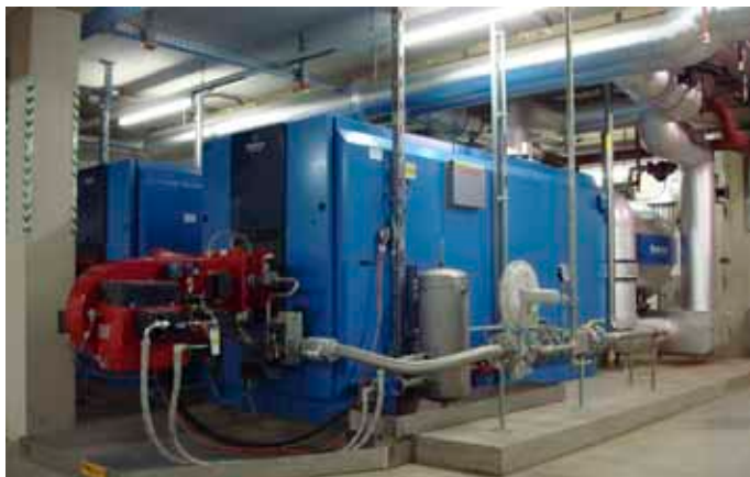
Einer der Weishaupt-Zweistoffbrenner mit Drehzahl- und O 2 -Regelung, der Gasstrasse und der Ölzufuhr.
