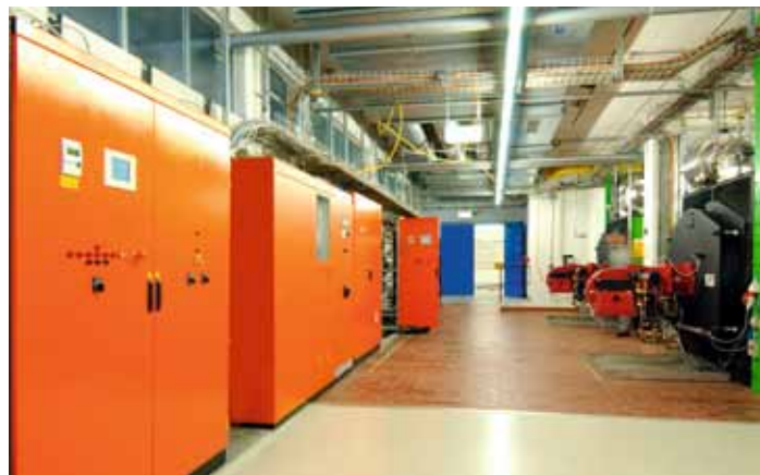
Sanierung Triemli: Heisswasserzentrale mit zwei multiflam®-Zweistoffbrennern RGL40/2-A 3LN mit Feuerungsmanager. Links im Bild die übergeordnete Leittechnik, die mit dem WH-Feuerungsmanager verbunden ist.
