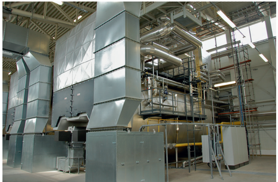
Gesamtkesselanlage mit Brennstoff-/Luftversorgung und Abgassystem. Foto Astebro/Weishaupt
