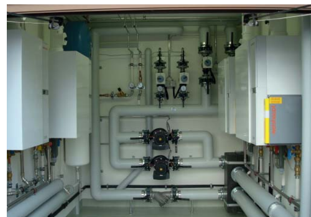
Die vier Wandkessel von Weishaupt mit hinten rechts der hydraulischen Weiche.
