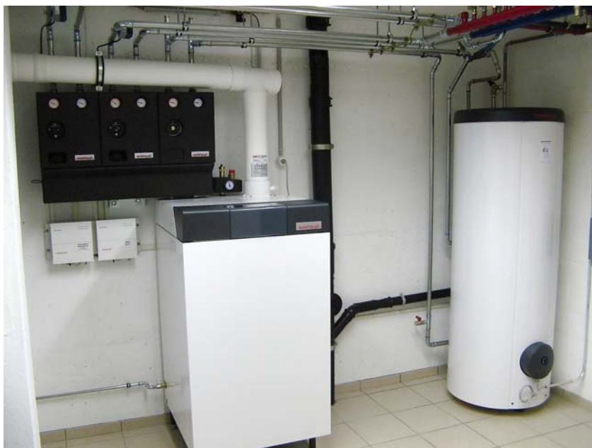
Der Einbau eines Thermo Condens von Weishaupt erwies sich als die zweckmässigste Sanierungsvariante.
