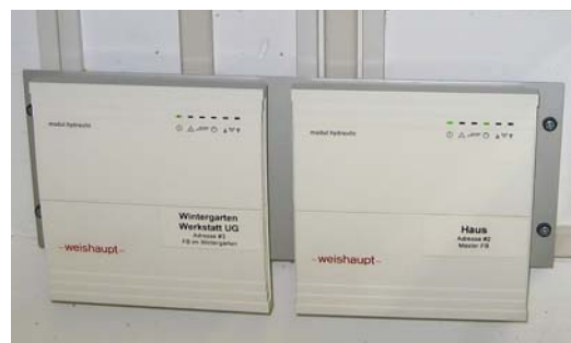
Die beiden Kommunikationsmodule sind für die individuelle Steuerung und Regelung der beiden Heizgruppen verantwortlich.
