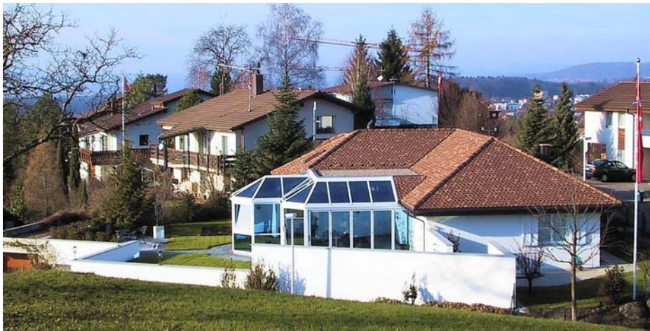
Ein neuer Ölkondensationskessel versorgt das Landhaus und den Wintergarten mit Wärme. (Fotos: Jürg Härrli)
