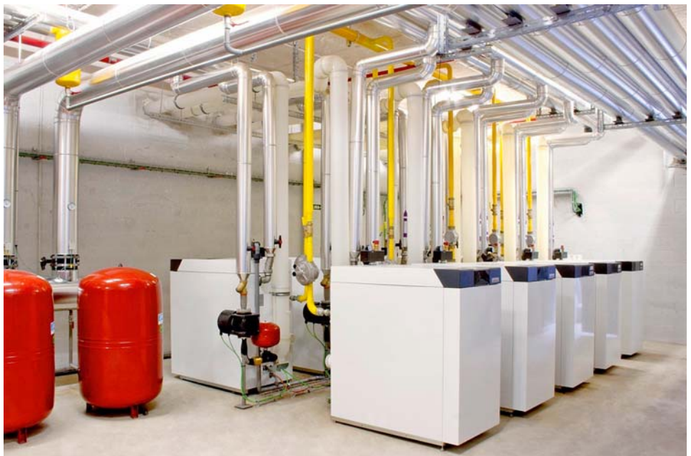
Durch Kaskadenschaltungen kann ein grösseres Leistungsspektrum erzielt werden. Beispielhaft kann dies am Einsatz von z. B. vier WTC-GB zu je 300 kW verdeutlicht werden. Modulationsband: 58 kW bis 1200 kW.
