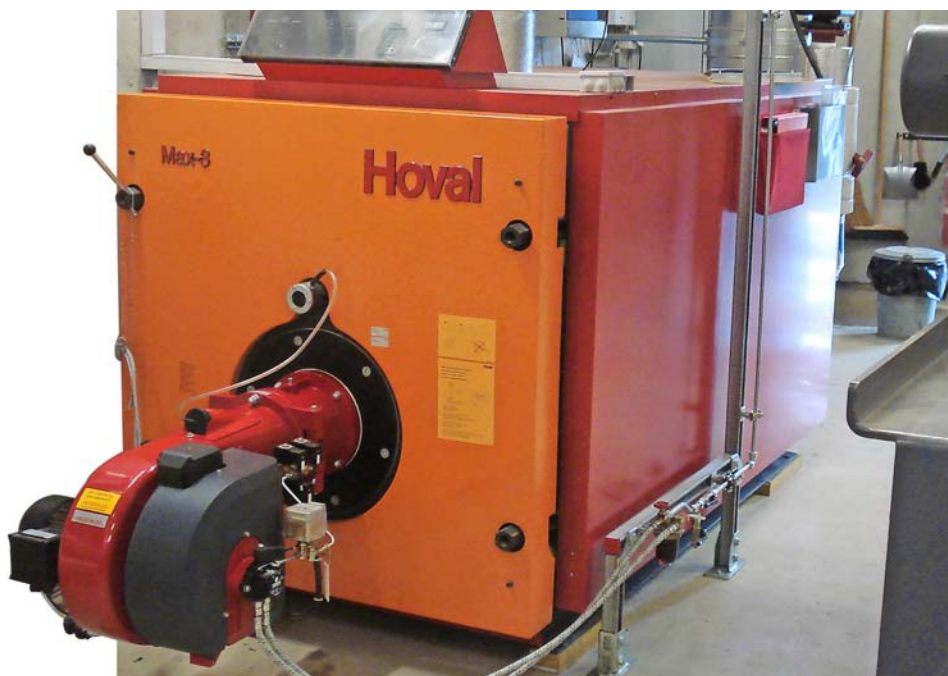
Mit der Ölheizung wird ein grosser Teil der Wärmeversorgung sichergestellt. Der montierte Weishaupt-Brenner ist mit dem Multiflam-Verbrennungssystem ausgerüstet.
