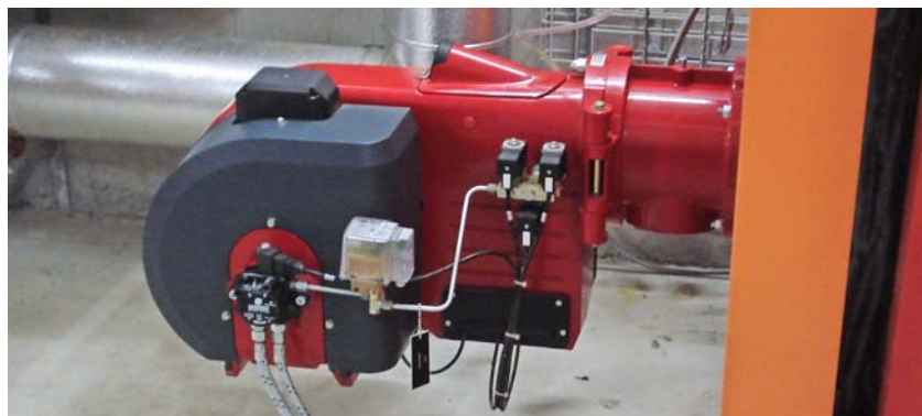
Über die Magnetventile in der Ölzuleitung wird der Brennstoff für die verschiedenen Düsen im Multiflam-Flammkopf gesteuert.
