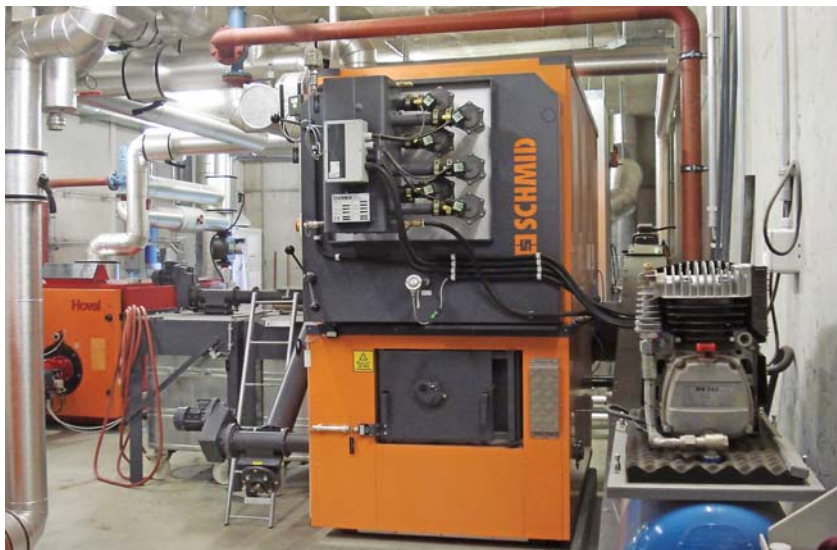
Holzschneitzel- und Ölheizung (links) sorgen im Wärmeverbund für die Energiebereitstellung.
