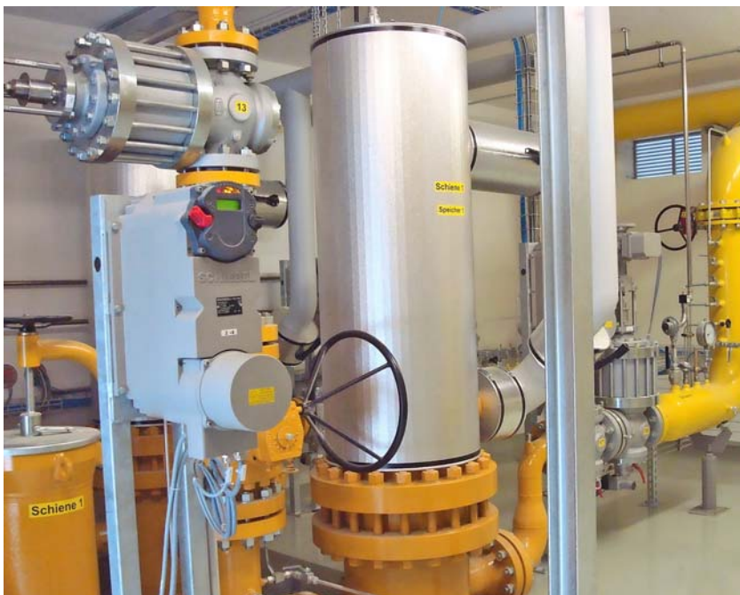
Blick in die Druckreduzierschiene mit Vorwärmer in Domat/Ems.
