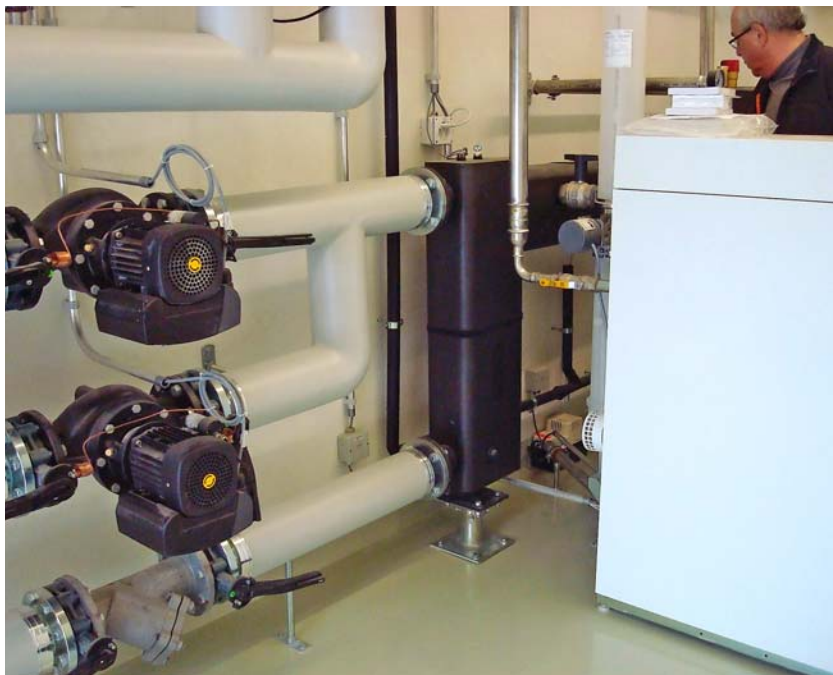
Hydraulische Weiche hinter den Standkesseln.
