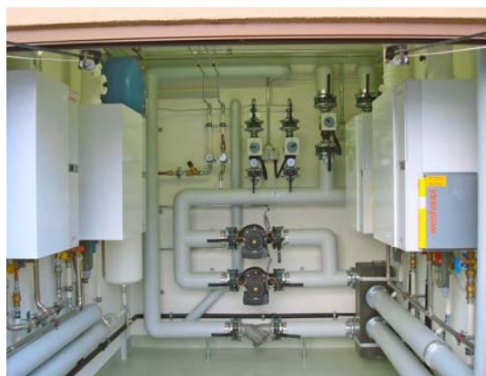
Die vier Weishaupt-Wandkessel, hinten rechts die hydraulische Weiche.
