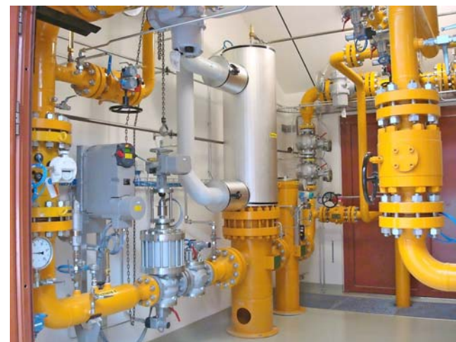
Die Druckreduzieranlage mit dem Vorwärmer zur Erdgasheizung in Maienfeld.
