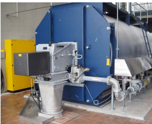
Einer der Kessel mit 9 MW-Weishaupt-Zweistoffbrenner in der ETH-Heizzentrale, welche die Niedertemperaturwärme auch für den Neubau liefert.
