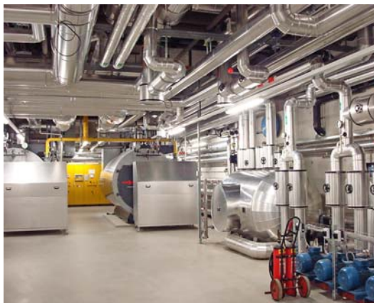
Die beiden Dampfkessel mit den Weishaupt-Zweistoffbrennern, rechts das Kondensat-Sammelgefäss.
