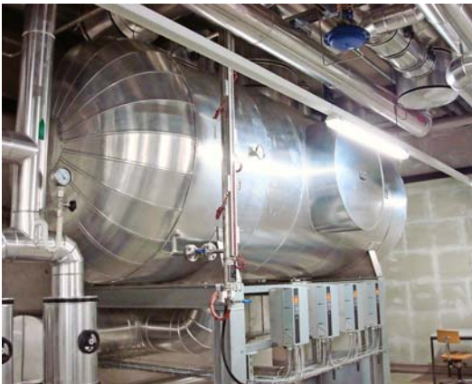
Der Speisewasserbehälter der Dampfanlage.
