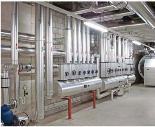
Die Dampf-Verteilanlage des Phenomics Center.
