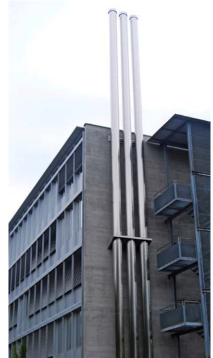
Die beiden Kamine mit den Befestigungen am Gebäude, das dritte Rohr dient der Ableitung von Brühdampf und als Sicherheitsausblasung.
