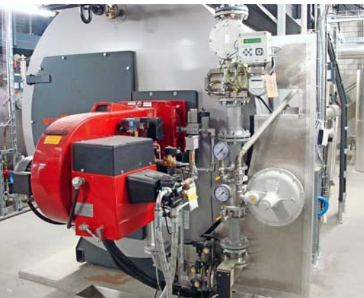
Weishaupt-Zweistoffbrenner «Monarch» an einem der Dampfkessel.
