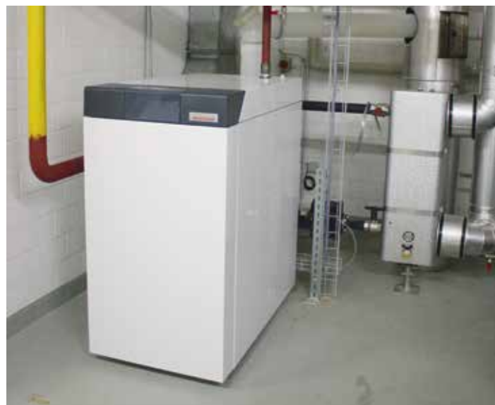
Der 270 kW-Weishaupt WTC-Brennwertkessel, hinten rechts die hydraulische Weiche
