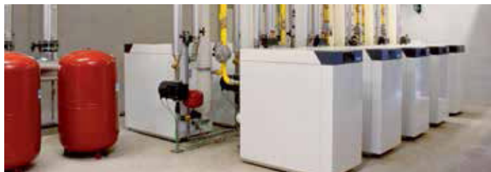
Bereits ein einzelner Weishaupt Gas-Brennwertkessel besitzt ein beachtlich breites Modulationsband. Durch Kaskadenschaltungen kann jedoch ein weitaus grösseres Spektrum erzielt werden. Beispielhaft kann dies am Einsatz von z.B. vier WTC-GB zu je 300 kW verdeutlicht werden. Bei dieser Konfiguration beginnt das Modulationsband bei 58 kW und endet bei 1200 kW.
