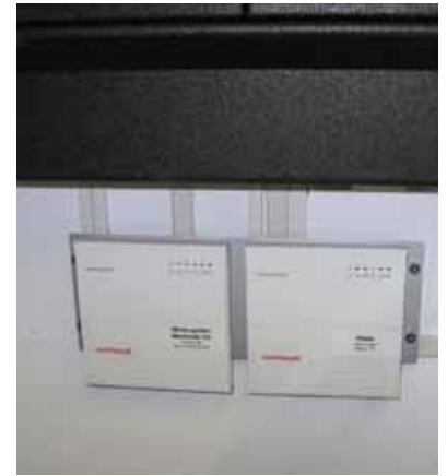
Die beiden Kommunikationsmodule sind für die individuelle Steuerung und Regelung der beiden Heizgruppen verantwortlich. (Foto Härrli)
