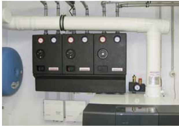
Vormontierte Anschlussgruppen ermöglichen eine übersichtliche Einbindung der neuen Anlage in das bestehende Heizsystem. Die Verbrennungsluft und die Abgase werden über das Kunststoffdoppelrohr geführt. (Foto Härrli)
