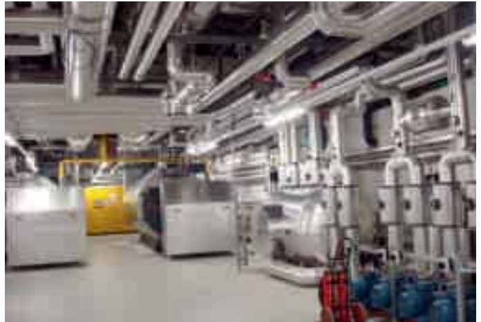
Die beiden Dampfkessel mit den Weishaupt-Zweistoffbrennern, rechts das Kondensat-Sammelgefäss.
