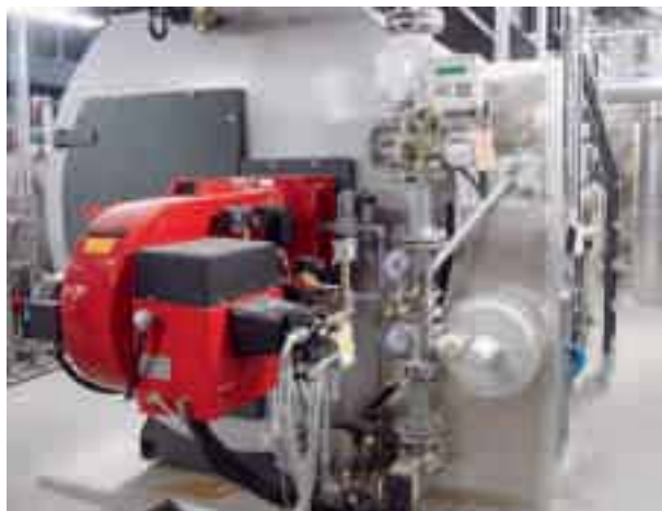
Der Weishaupt-Monarch-Zweistoffbrenner an einem der Dampfkessel.
