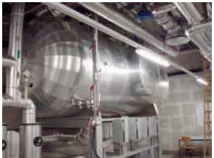
Der Speisewasserbehälter der Dampfverteilanlage.
