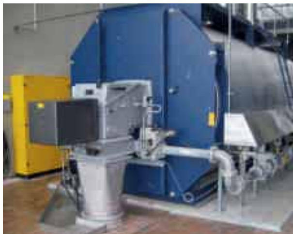
Einer der Kessel mit 9-MW-Weishaupt-Zweistoffbrenner in der ETH-Heizzentrale, welche die Niedertemperaturwärme auch für den Neubau liefert.
