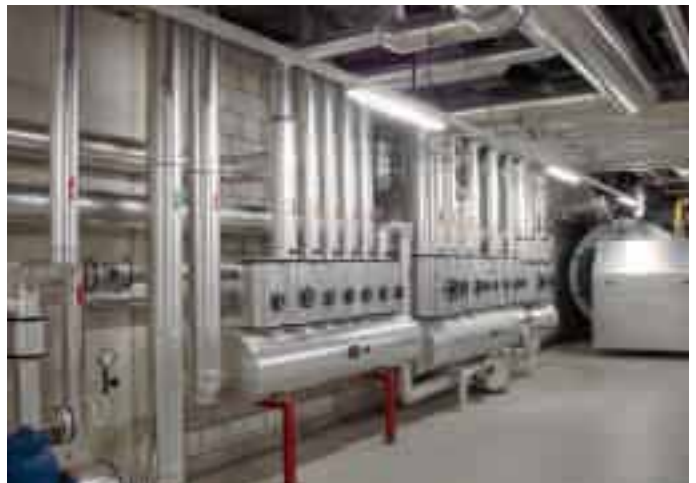
Die Dampfverteilanlage des ETH Phenomics Center auf dem Höggerberg.
