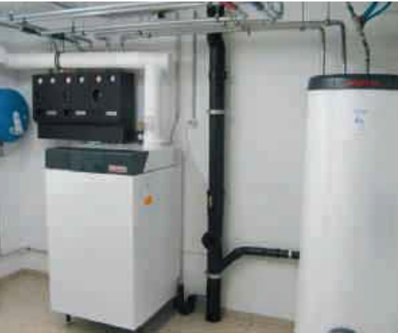
Für den Sanierungsmarkt können kostengünstige Lösungen angeboten werden. Das Beispiel zeigt einen Ölbrennwertkessel mit Trinkwasserspeicher in einem Landhaus.
