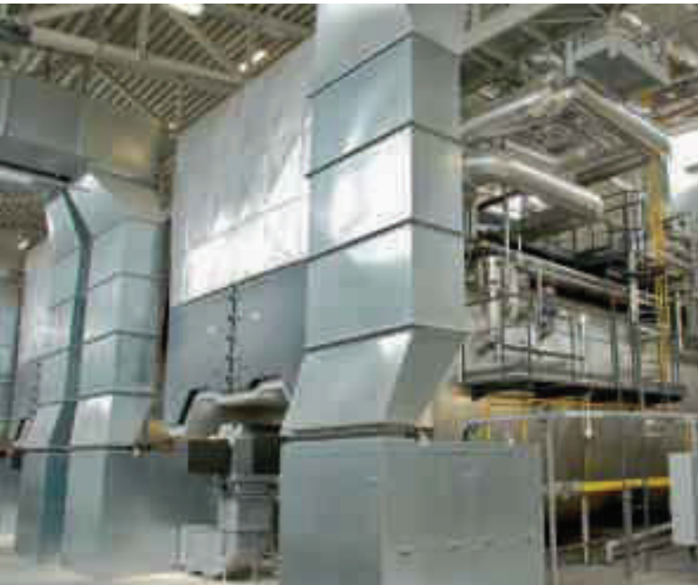
Gesamtkesselanlage mit Brennstoff-/Luftversorgung und Abgassystem.
