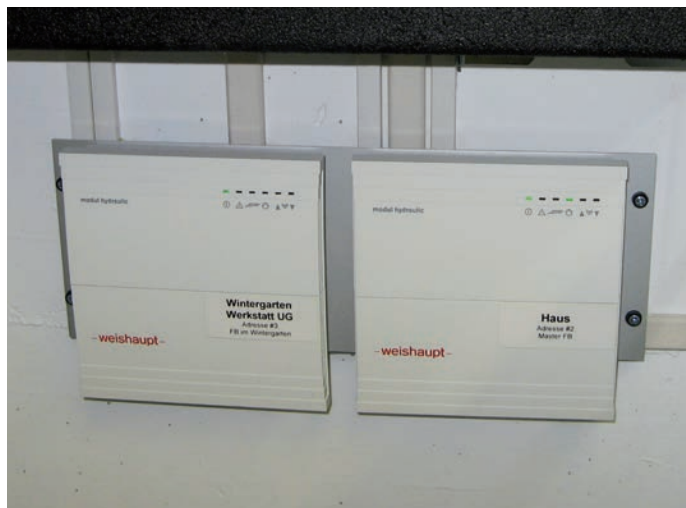
Die beiden Kommunikationsmodule sind für die individuelle Steuerung und Regelung der beiden Heizgruppen verantwortlich.
