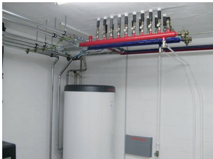
Problemlose Integration in die vorhandene Infrastruktur – Anschluss an die bestehenden Heizverteiler.
