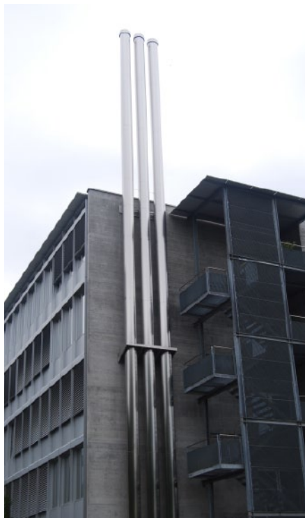
Die beiden Kamine mit den Befestigungen am Gebäude, das dritte Rohr dient der Ableitung von Brüdendampf und als Sicherheitsausblaseung.
