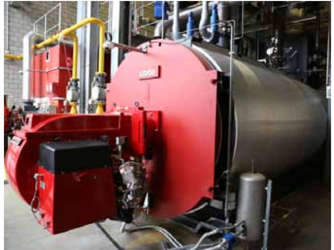
Der neue Astebo-5-MW-Heisswasserkessel mit dem Weishaupt-Zweistoffbrenner.
