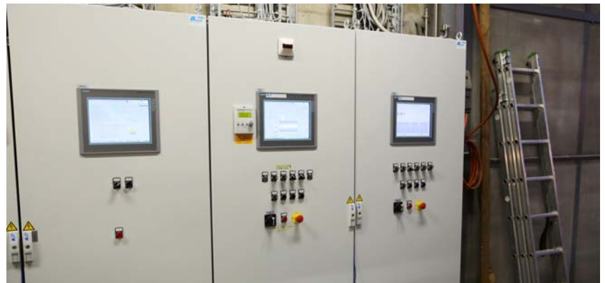
Der neue Schaltschrank in der Heizzentrale.
