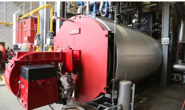
Der neue asteco-5 MW-Heisswasserkessel mit Weishaupt-Zweistoffbrenner.
