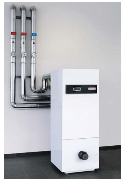
Die Weishaupt Sole-Wasser-Wärmepumpe bezieht den Grossteil der erforderlichen Heizenergie aus der im Erdreich gespeicherten Sonnenenergie.
