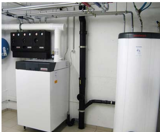
Kostengünstige Lösungen können dank Weishaupt-Systemtechnik für den Sanierungsmarkt angeboten werden. Das Beispiel zeigt einen Ölbrennwertkessel mit Trinkwasserspeicher in einem Landhaus.
