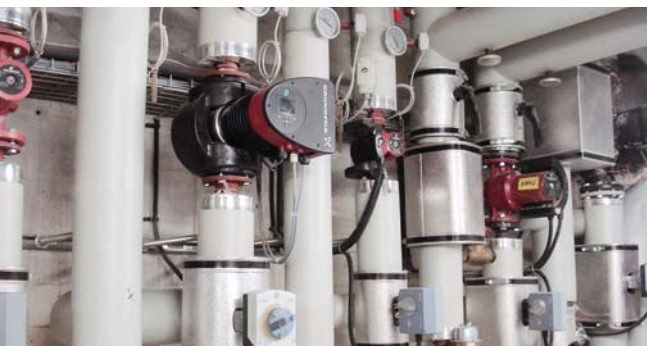
Elektrische Energie wird durch den Einsatz von stufenlos regulierten Pumpen eingespart.
