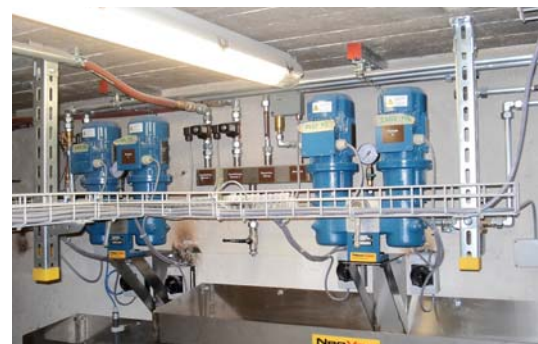
Zwei Doppelpumpengruppen versorgen den Tagestank und die beiden Brenner mit Heizöl.
