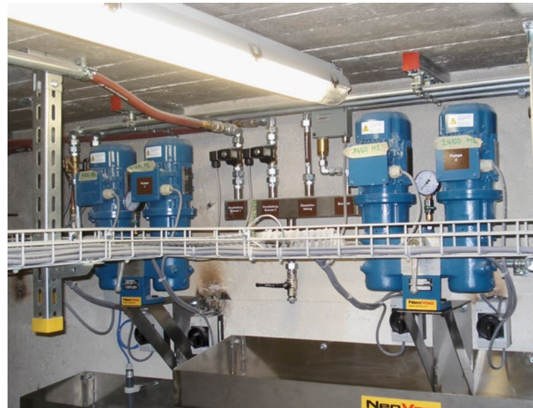
Zwei Doppelpumpengruppen versorgen den Tagestank und die beiden Brenner mit Brennstoff.
