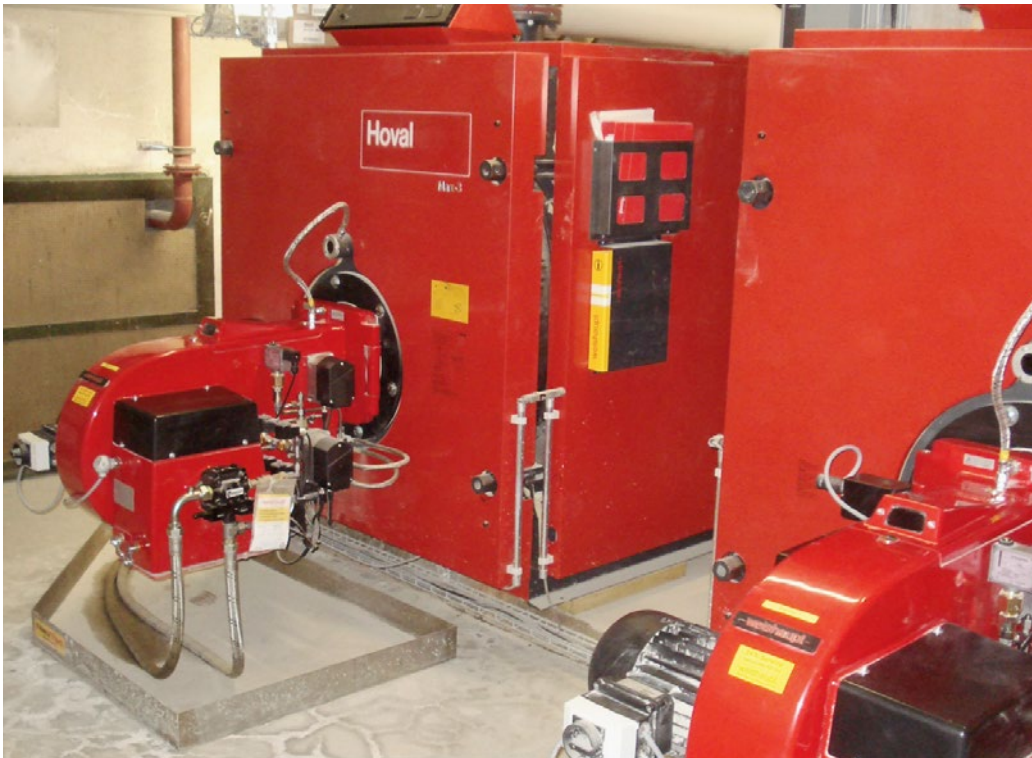
An die Wärmeerzeugung werden höchste Anforderungen bezüglich Wirtschaftlichkeit und Umweltverhalten gestellt. Im Vordergrund die beiden Ölbrenner von Weishaupt.
