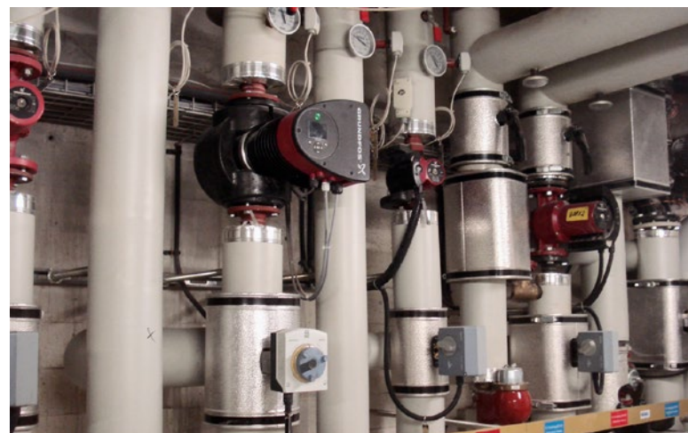
Elektrische Energie wird durch den Einsatz von stufenlos regulierten Pumpen eingespart.
