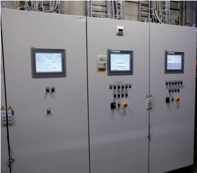
Der neue Schaltschrank in der Heizzentrale.
