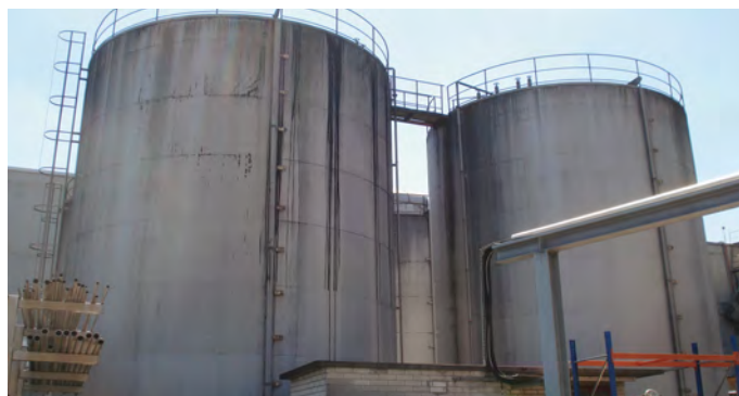
Vom Tanklager – Kapazität von 1,3 Mio. l Heizöl – gelangt der Brennstoff über die freistehende Leitungstrasse zum Tagestank im Kesselhaus. (Bild: K. Rüegg)
