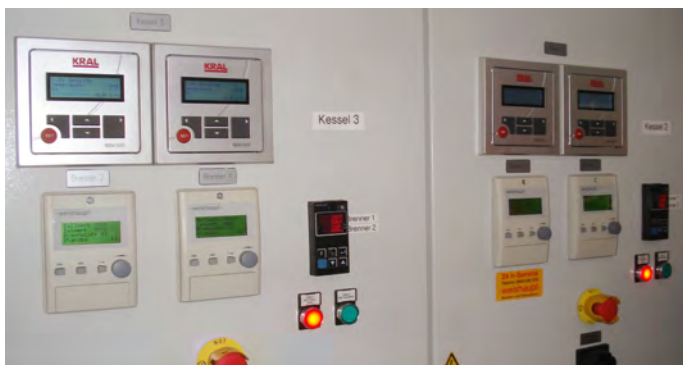
Alle Anlagendaten auf einen Blick, der Betriebsablauf wird zentral gesteuert und überwacht. (Bild: zVg)
