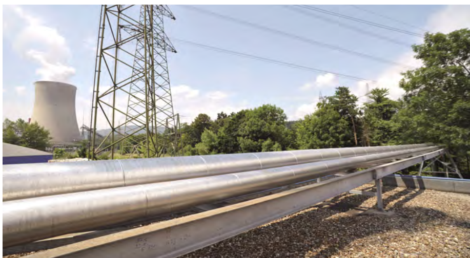
Das Kernkraftwerk Gösgen liefert über eine Fernleitung von 1,8 km Länge Dampf für die Papierfabrik. (Bild: KKW Gösgen)
