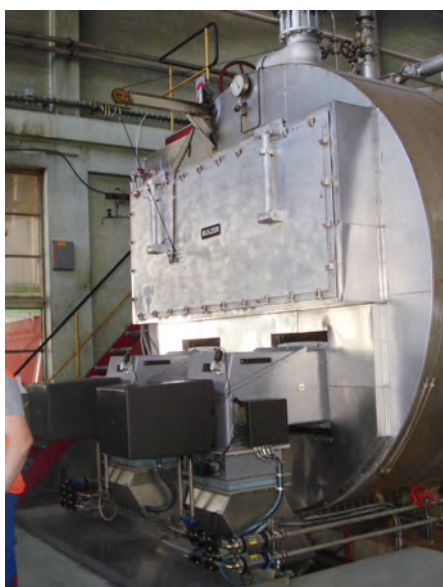
Mit zwei Kesseln mit Doppelflammrohren und den darauf montierten 4 Industriebrennern wird die Dampfversorgung bei Stillstand des Kernkraftwerkes sichergestellt. Ansicht auf eine der beiden Kesseleinheiten. (Bild: K. Rüegg)
