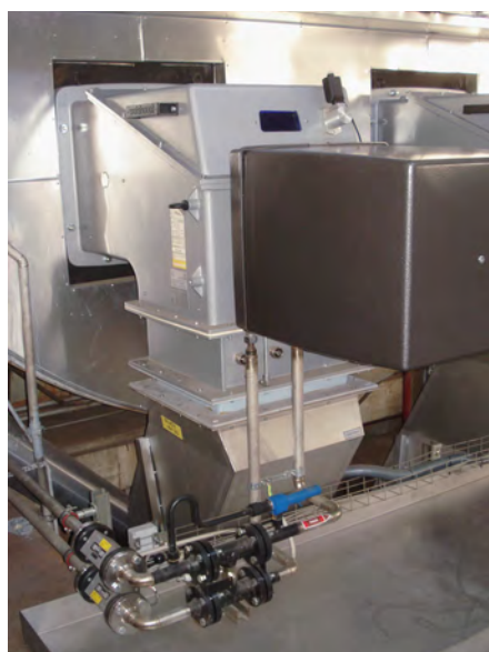
Einer der 4 Industriebrenner für die Dampfproduktion zur Papier- und Kartonherstellung. Gut sichtbar sind die Brennstoffzufuhr und der Anschluss an den Ventilator, der sich im Untergeschoss befindet. (Bild: zVg)
