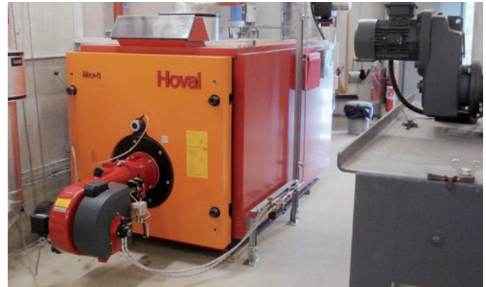
Mit der Ölheizung wird die Spitzenlast für die Wärmeversorgung abgedeckt. Der Brenner ist mit einem Multiflam-Verbrennungssystem ausgerüstet.
