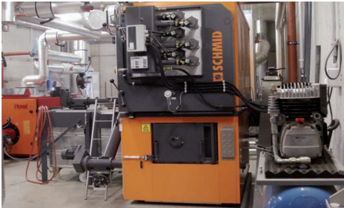
Holzschneitzel- und Ölheizung sorgen im Wärmeverbund für die Energiebereitstellung. (Bilder: Weishaupt)
