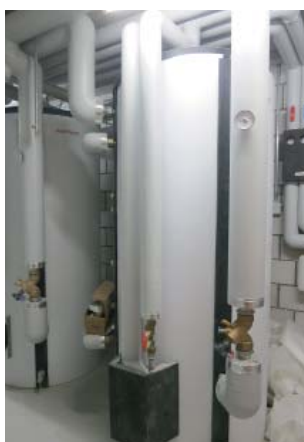
Trinkwassererwärmer mit zwei Energiespeichern zu je 910 Liter.
