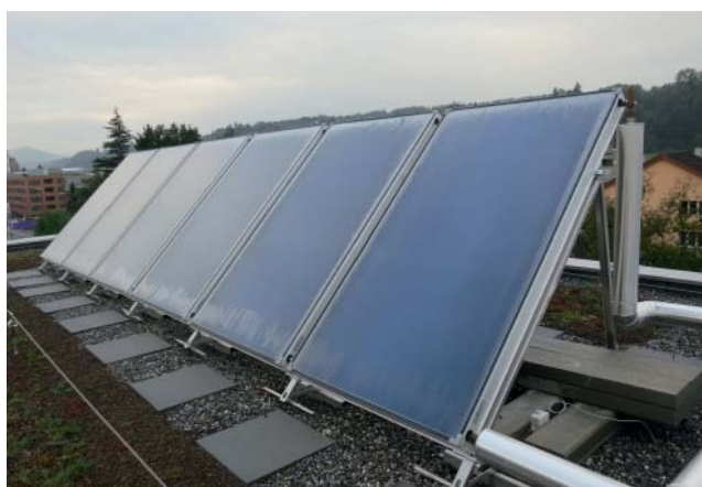
Die Flachdach-Solaranlage «WTS-F2» bei der Wohnüberbauung in Ebikon.
