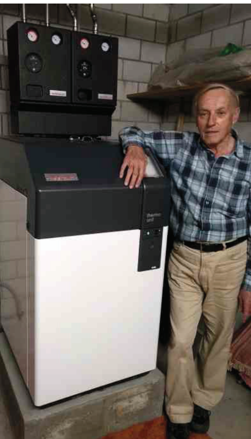
Eigentümer Rolf Rüegg ist zufrieden mit der Heizungssanierung.
