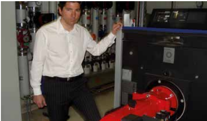
Direktor Thomas Vogt ist begeistert. Die sanierte Ölheizung leistet einen grossen Anteil an das vereinbarte Energiesparziel. Foto: K. Rügegg
