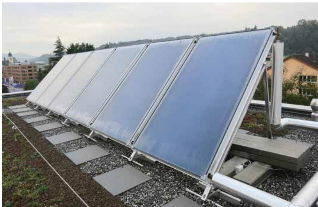
Die Flachdach-Solaranlage WTS-F1 bei der Wohnüberbauung in Ebikon.
