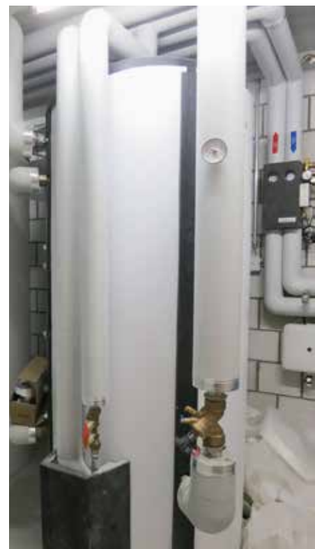
Die Weishaupt-Trinkwassererwärmer sind optimal zur Kombination mit Weishaupt-Solarsystemen geeignet. Im Falle der Anlage in Ebikon wurden zwei Energiespeicher zu je 910 Liter eingesetzt.
