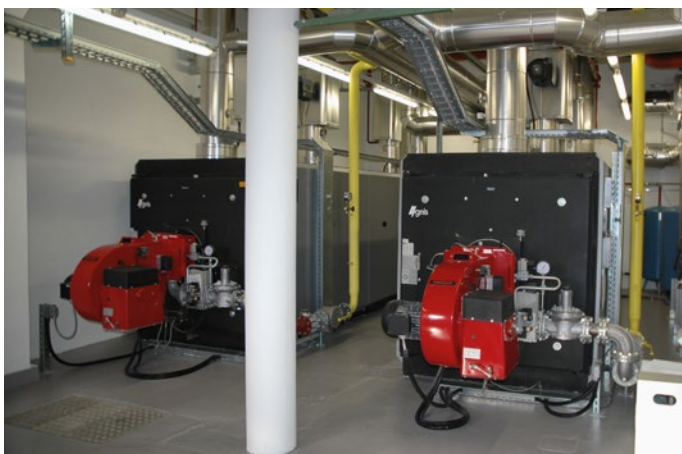
Die beiden neuen 2,15-MW-Kessel mit Weishaupt-Gas-Gebläseburnern.
