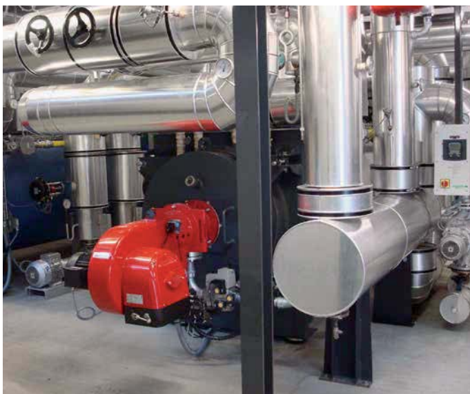
Der neue Thermoölkessel mit modulierendem Weishaupt-Gasgebläse-brenner.
