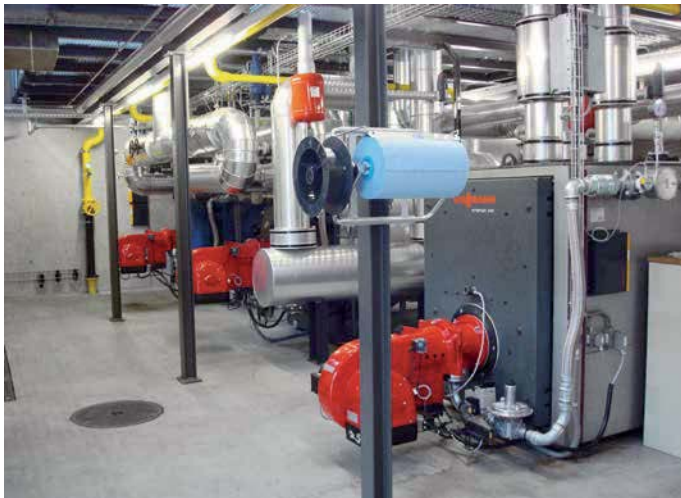
Links zwei Thermoöl- und rechts der Heizwasserkessel mit ihren Weishaupt-Monarch-Gas-Gebläsebrennern.
