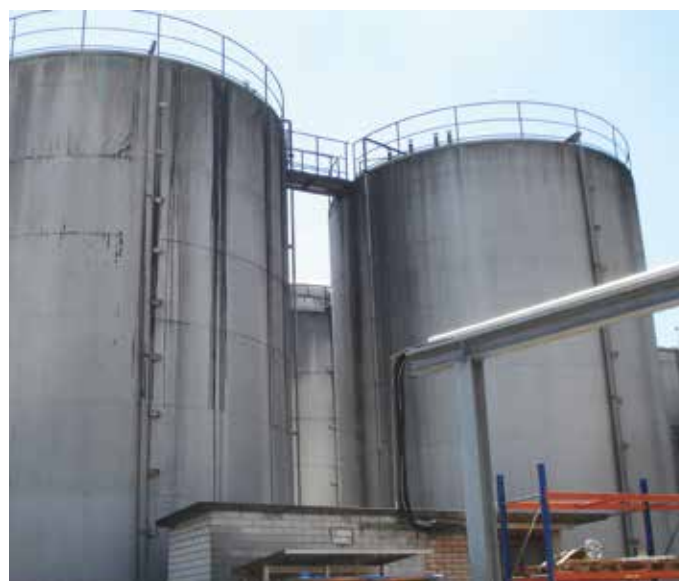
Vom Tanklager mit einer Kapazität von 1,3 Mio. Litern Heizöl wird der Brennstoff über das freistehende Leitungstrasse zum Tagestank im Kesselhaus transportiert.
