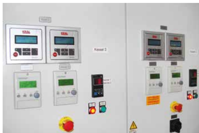
Alle Anlagedaten auf einen Blick, der Betriebsablauf wird zentral gesteuert und überwacht.
