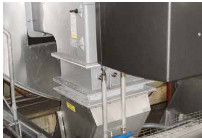
Einer der vier Industriebrenner für die Dampfproduktion. Gut sichtbar sind die Brennstoffzufuhr und der Anschluss an den Ventilator im Untergeschoss.
