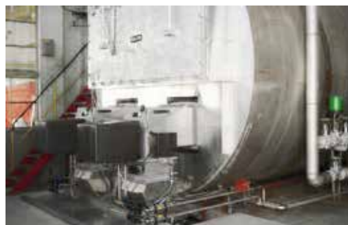
Mit zwei Kesseln mit Doppelflammrohren und den darauf montierten vier Industrierennern wird die Dampfversorgung bei Stillstand des Kernkraftwerkes sichergestellt (Ansicht auf eine der beiden Kesselanlagen). Foto: K. Rüegg
