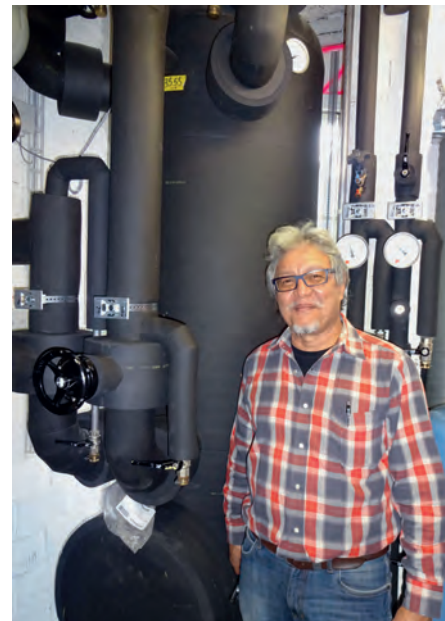
Der Kältespeicher – und Franco Meier konnte nicht mehr weg ...
