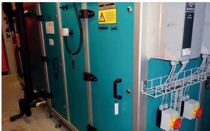
Eine der Lüftungsanlagen.
