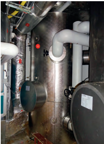
Wärme- und Kältespeicher im UG.
