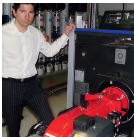
Direktor Thomas Vogt ist begeistert. «Die sanierte Ölheizung leistet einen grossen Anteil an das vereinbarte Energiesparziel». (Bild: K. Rüegg)
