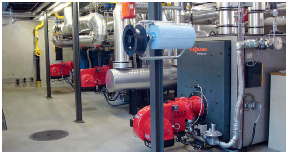
Hinten zwei Thermoöl- und vorne der Heizwasserkessel – jeweils mit Monarch-Gas-Gebläseburnern.
