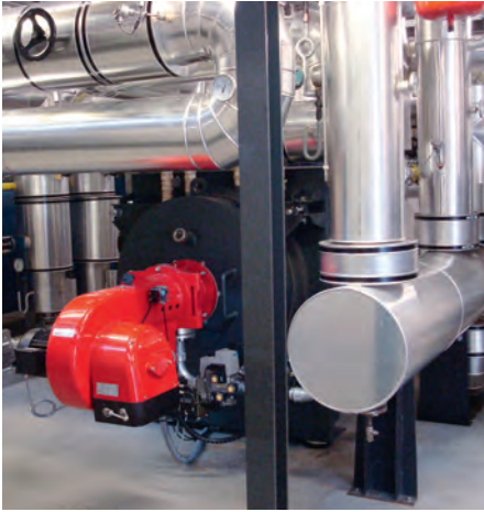
Der neue Thermoölkessel mit modulierendem Weishaupt-Gasgebläsebrenner.
