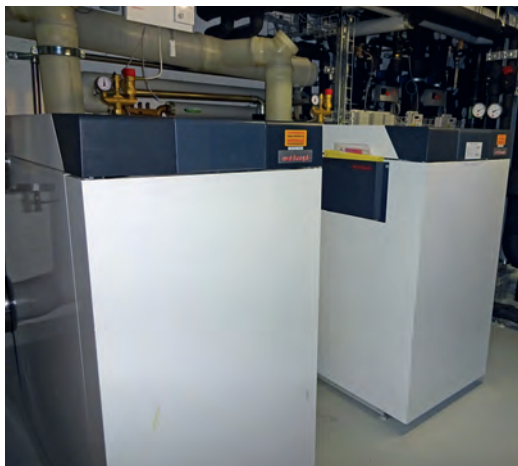
Gas-Brennwertkessel Weishaupt WTC-GB 210 im 4. OG.
