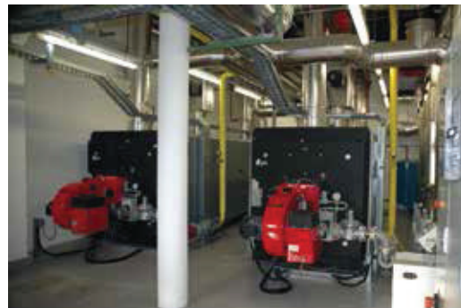
Die beiden neuen 2,15 MW-Kessel mit Weishaupt-Gas-Gebläsebrennern
