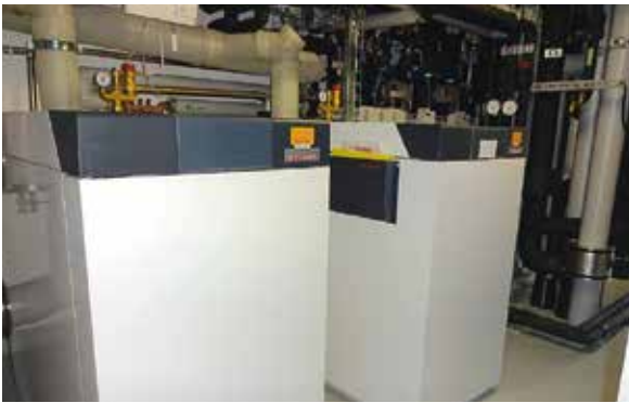
Die Weishaupt Gaskessel mit je 200kW liessen sich auf engstem Platz installieren.
