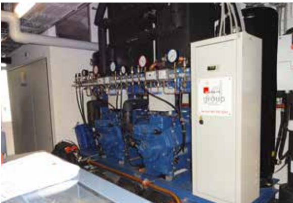
Die Kältemaschine im 4.OG.
