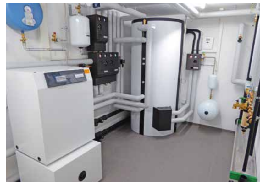
Kombispeicheranlage mit Sole/Wasser-Wärmepumpe (links) und Energiespeicher.
