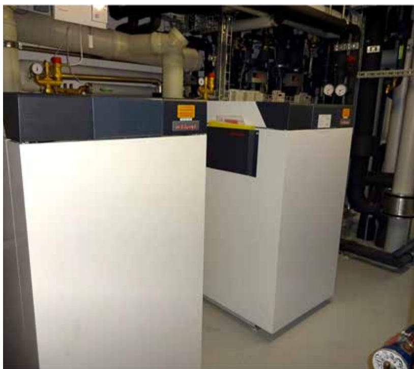
Die zwei Gaskessel mit je 200 kW liessen sich auf engstem Raum installieren – mit optimaler Leistung.
