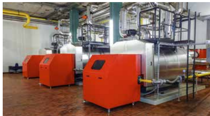
Die drei Hoval-Warmwasserkessel mit Weishaupt-Monarch-Gebläseburnern in der neuen Heizzentrale
