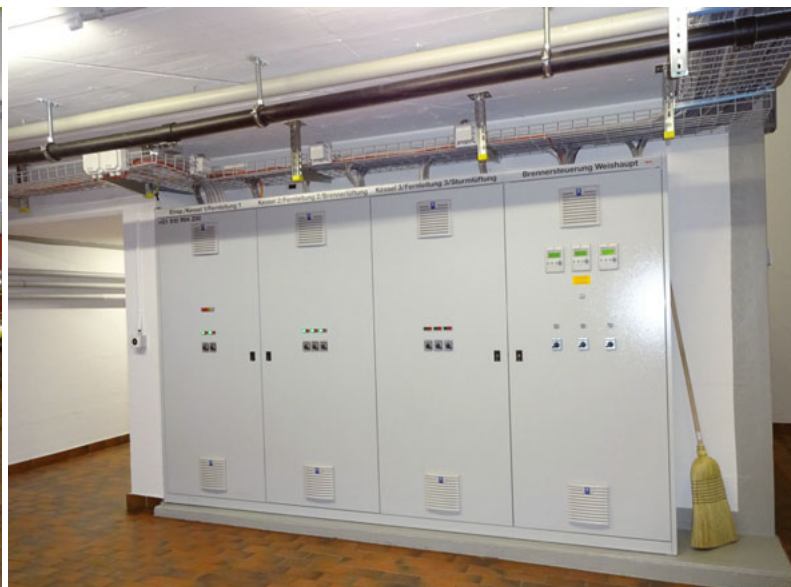
Der neue Steuerungsschrank von Weishaupt.
