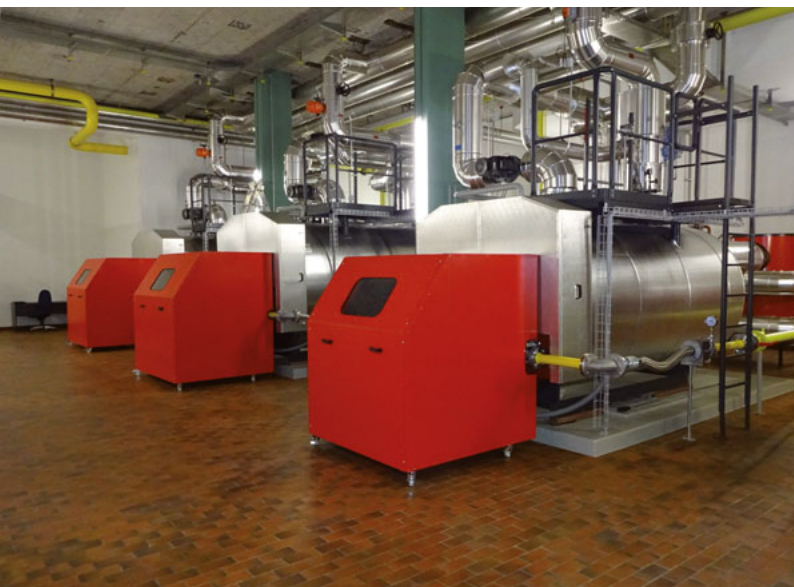
Die drei Hoval-Warmwasserkessel mit Weishaupt-Monarch-Gebläseburnern in der neuen Heizzentrale.
