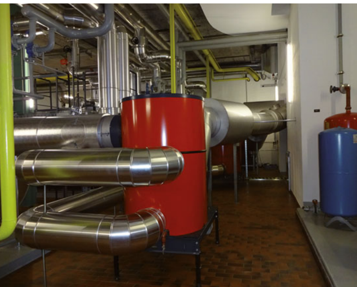
Die AF-Thermokondensatoren hinter den Kesseln nutzen den Brennwert des Gases.
