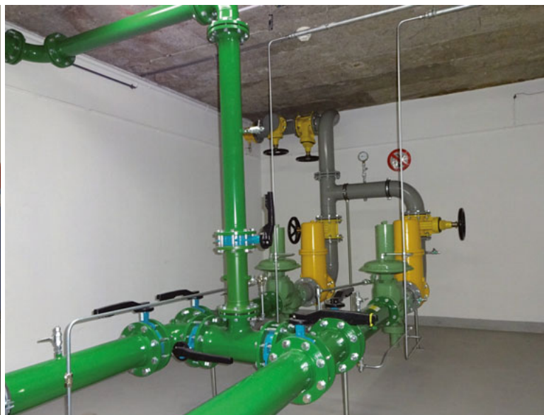
Die neue Gas-Druckreduzierstation.
