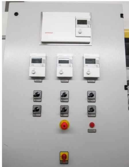
Der Schaltschrank der Anlage.
