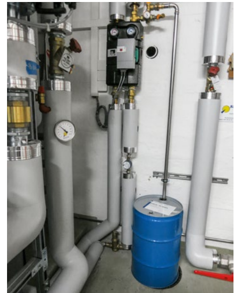
Die Solarstation mit Auffanggefäß sorgt für Sicherheit bei Überdruck.
