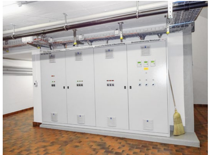
Der neue Steuerungsschrank von Weishaupt.
