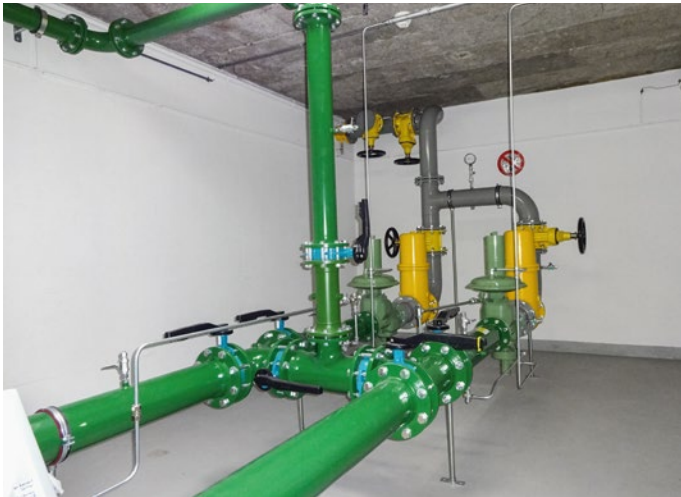
Die neue Gas-Druckreduzierstation.
