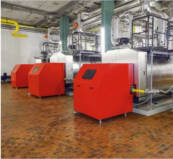
Die drei Hoval-Warmwasserkessel mit Weishaupt-Monarch-Gebläseburnern in der neuen Heizzentrale.
