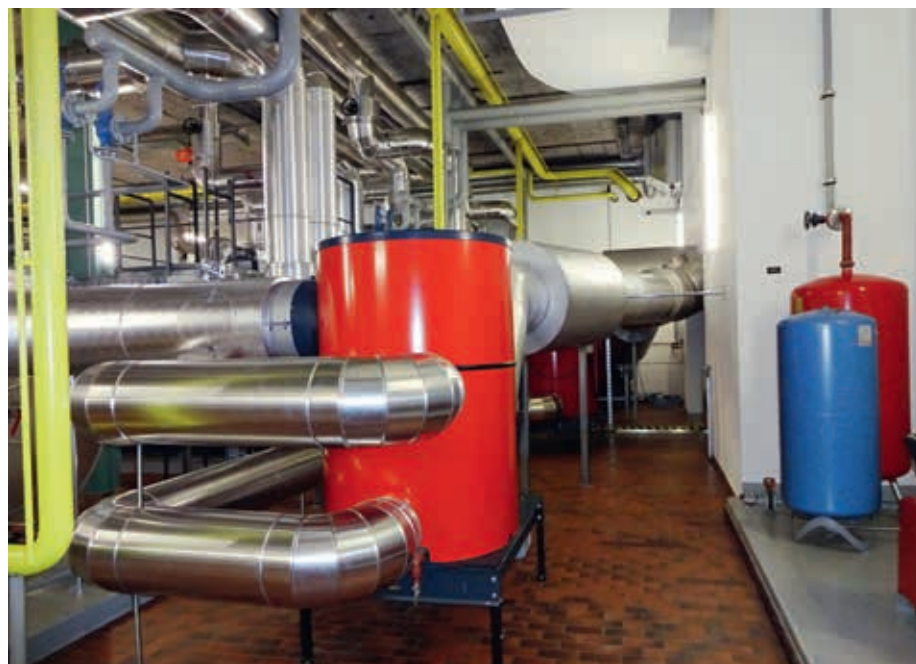
Die Hoval-AF-Thermokondensatoren hinter den Kesseln nutzen den Brennwert des Gases.
