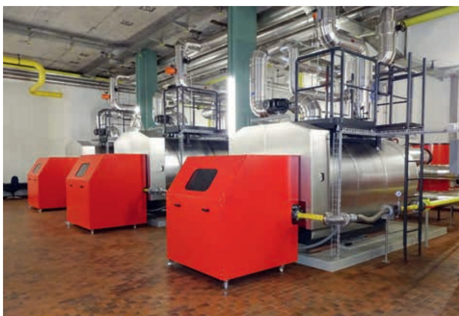
Die drei Hoval-Warmwasserkessel mit Weishaupt-Monarch-Gebläse-brennern in der neuen Heizzentrale.
