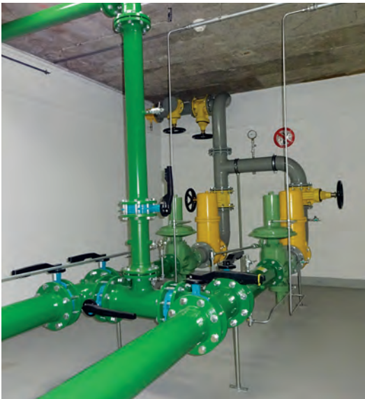
Die neue Gas-Druckreduzierstation.
