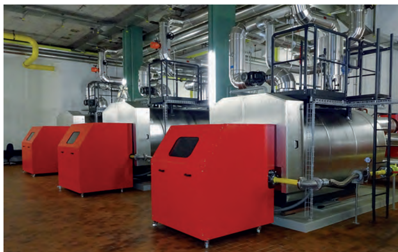
Die drei Hoval Warmwasserkessel mit Weishaupt Monarch-Gebläseburnern in der neuen Heizzentrale.
